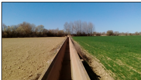
Acequia prefabricada en Villaturde
