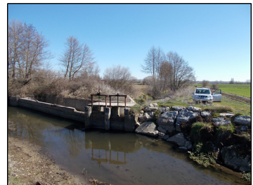
Entronque de la Perihonda con su desagüe principal Villamoronta
