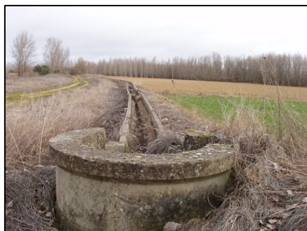
Acequia prefabricada en Torre de los Molinos
